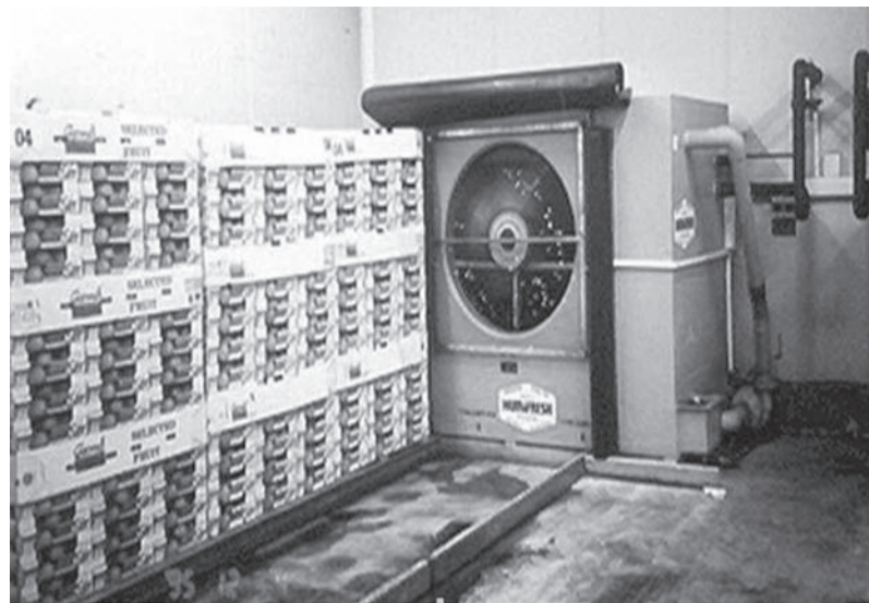
Hlađenje uz pomoć hladnog zida
