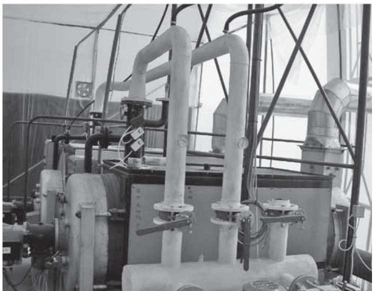
Vodogrejni kotlovi na zemni gas
